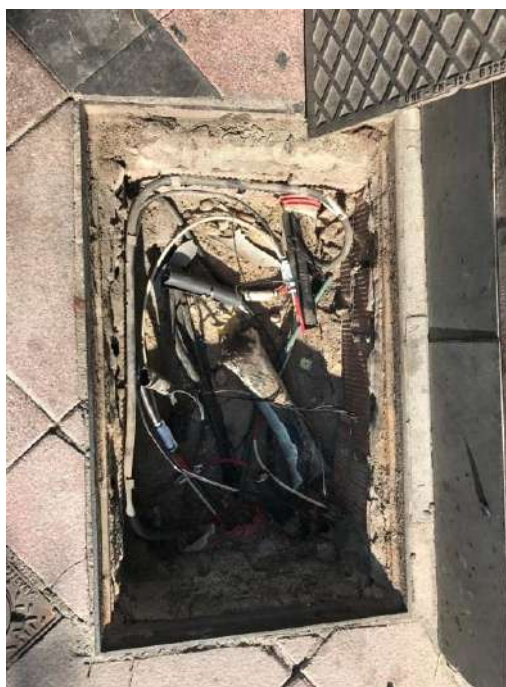
Arqueta de Telefónica
